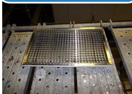
充填室吹き出し口 器具
