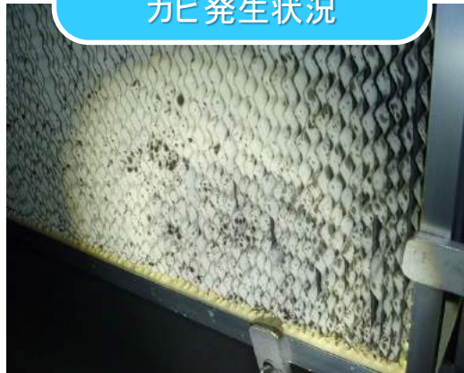
交換前フィルター カビ発生状況
