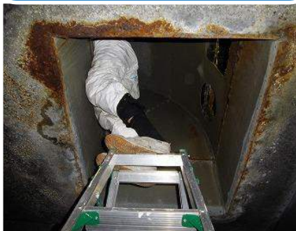
AHU内部 RAダクト
