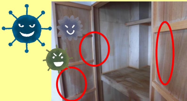
■押し入れに白いカビが発生していた現場
