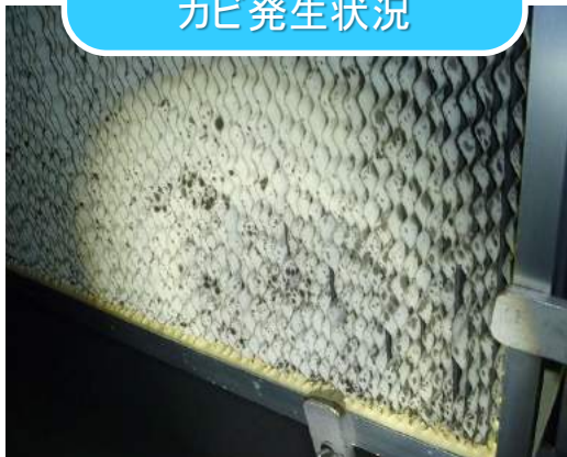
交換前フィルター カビ発生状況
