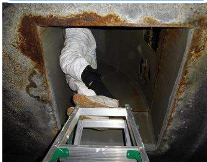
AHU内部 RAダクト
