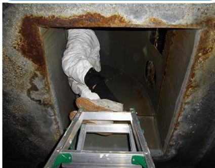
AHU内部 RAダクト
