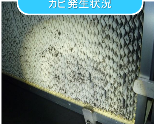
交換前フィルター カビ発生状況
